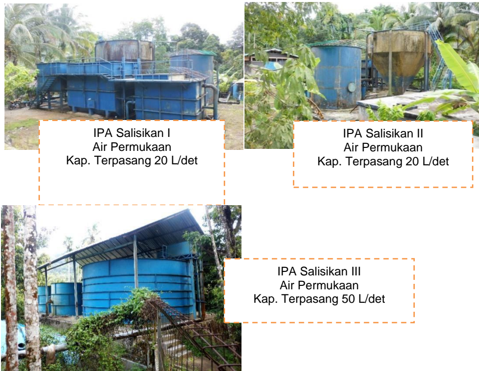
Gambar III.2 Unit Produksi pada Sumber Air Salisikan I, II, dan III
