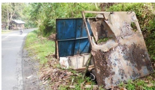
Kondisi Water Meter Rusak
